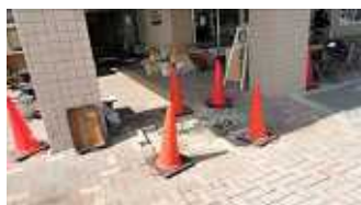
陥没した宮城野の里玄関付近
